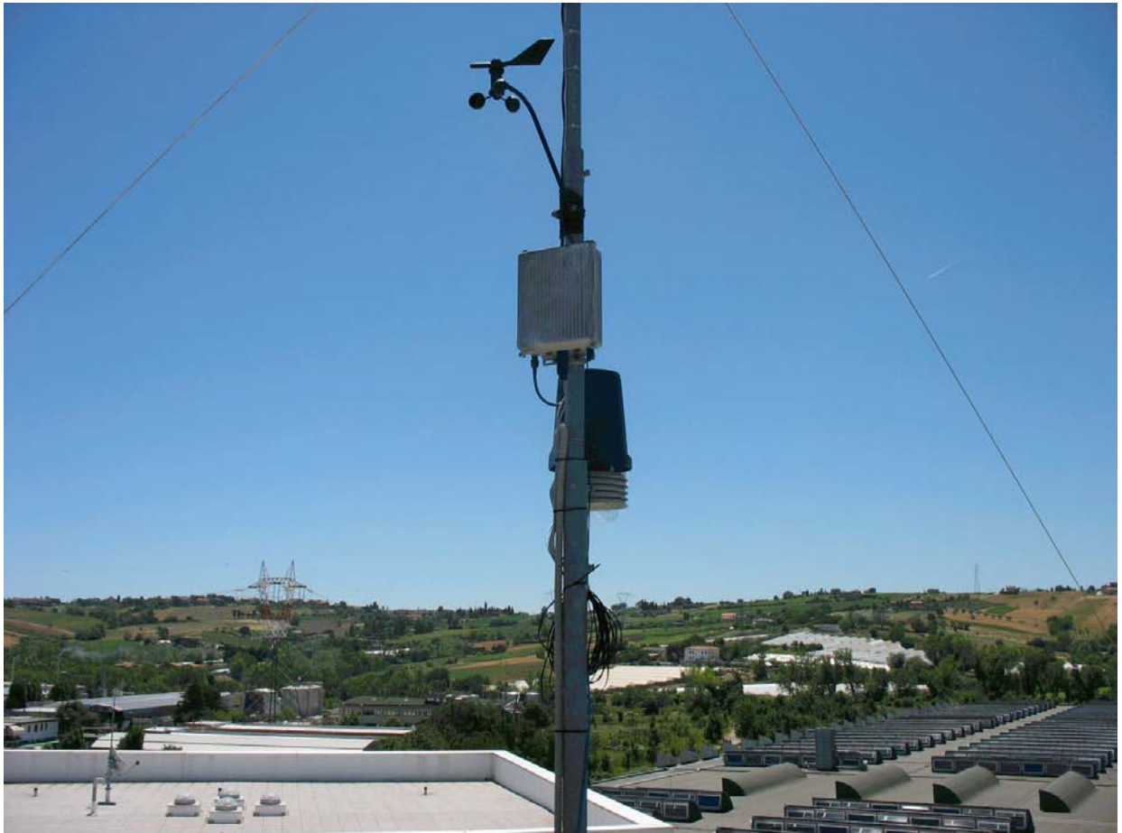
Figura 1 Stazione meteorologica posizionata sulla copertura dell'edificio Tonelli a Rovereta
